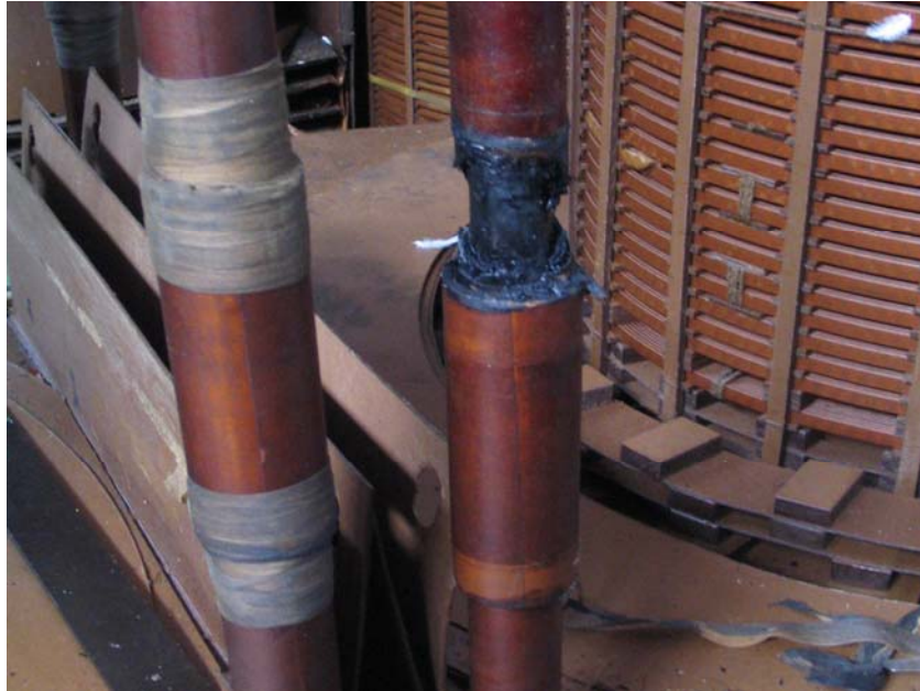
Slika 13. Aktivni deo havarisanog transformatora – vertikalni zavrtnjevi magnetnog kola i namotaji
