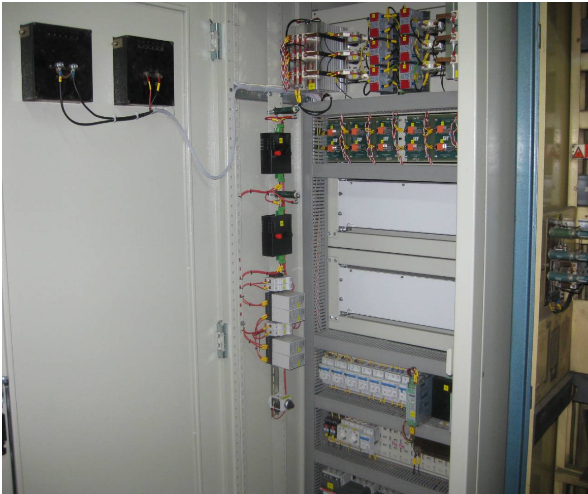
Izgled ormara sistema pobude bloka 5 u TE "Kolubara A5"
