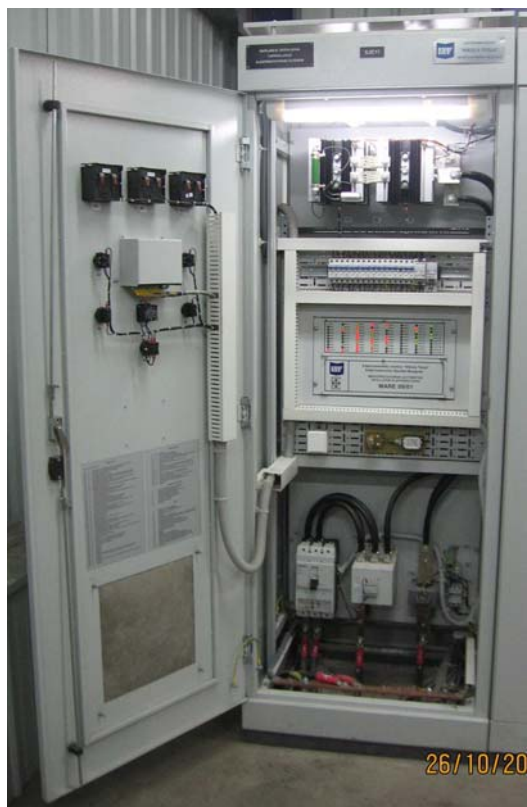
Slika 3. Unutrašnji izgled upravljačkog ormara elektrofiltera
