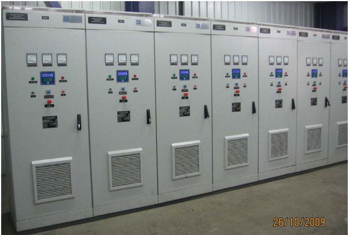
Slika 2. Spoljni izgled sistema za napajanje i upravljanje elektrofilterom
